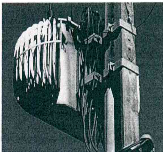
Ilustração 1: Transformador de Potência com vazamento de óleo isolante
