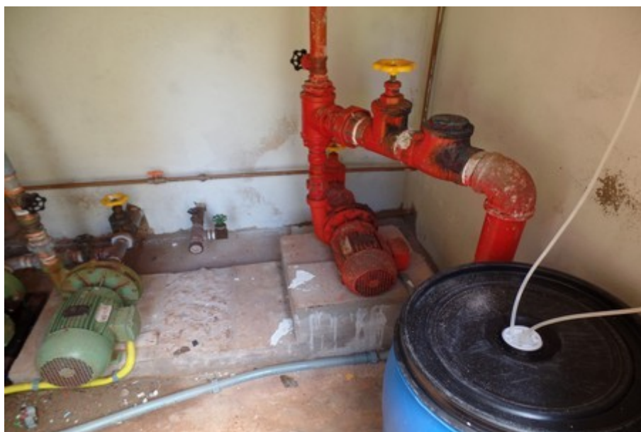
Figura 3 – Casa de bombas.
