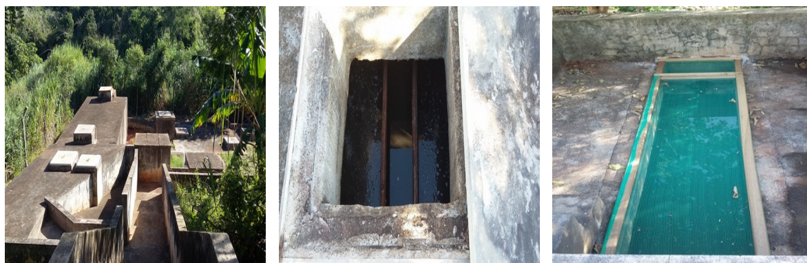
Figura 4 - Estação de tratamento de esgoto.
